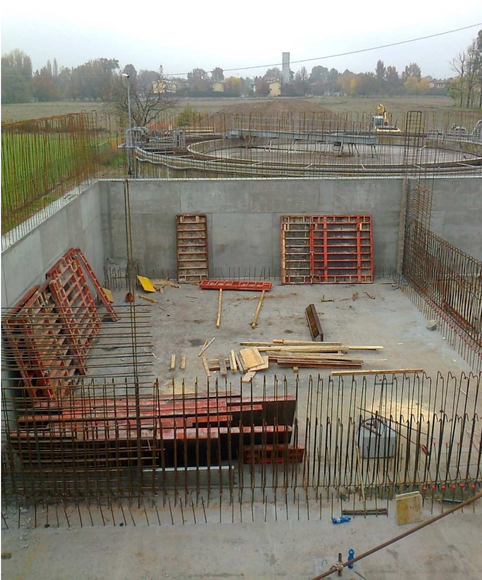
Foto 1 – Nuova vasca biologica depuratore Flero
