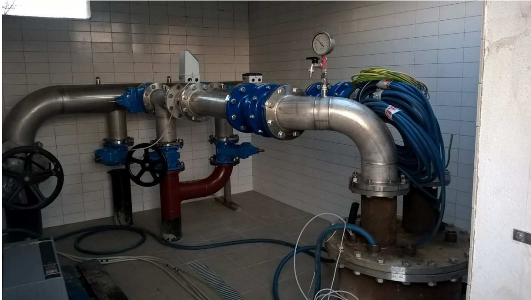
Foto 1 – Pozzo Breda 2 – armamento idraulico
