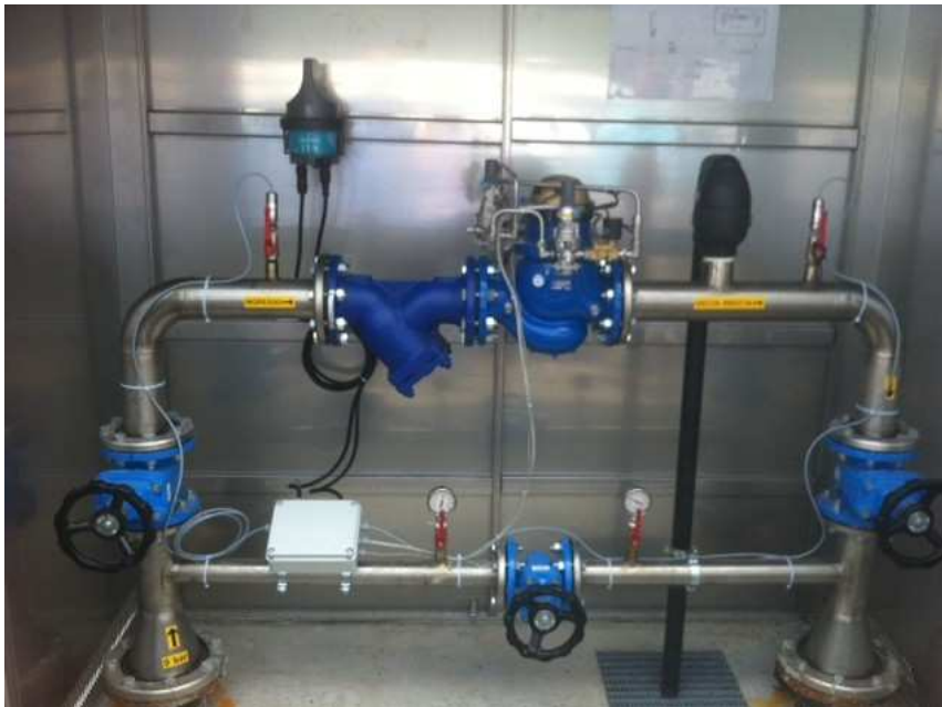
Figura 11.3: Esempio di strumentazione installata all’ingresso di un distretto – valvola di riduzione con idrometro integrato con controllo a distanza dei set point di pressione notturna e diurna mediante solenoide – logger di trasmissione dati
